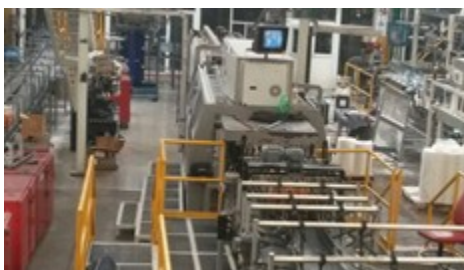
Figura 6.- - Subsistema de Empacado: Transportadores de botellas, Empacadora, Horno, transportadores de paquetes
