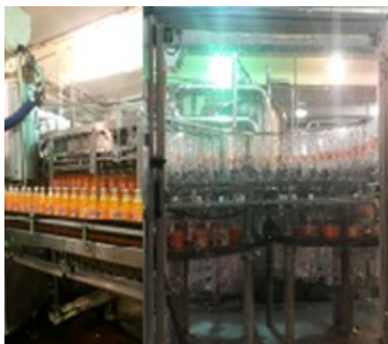
Figura 5.- - Subsistema de Llenado: Mezclador, Llamadora y Rinser
