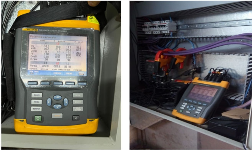
Fig. 7. Analizador de calidad de energía conectado en tableros de la FI-UNaM.
