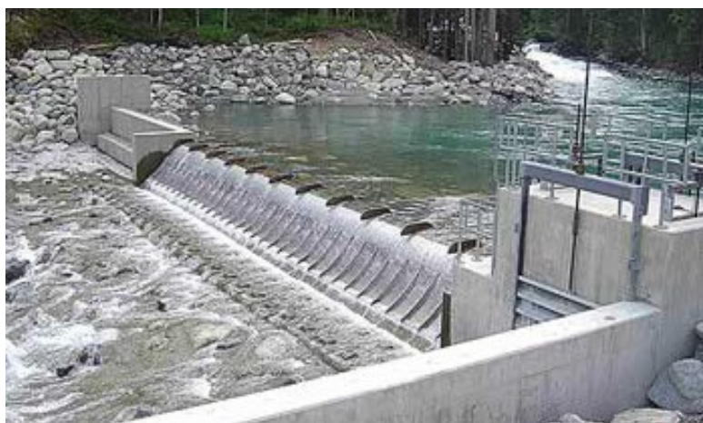
Fig. 4: Obra de toma con Rejilla auto-limpiante tipo Coanda.
