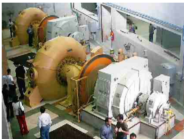
Fig. 5 PAH con turbinas tipo Francis de eje Horizontal (Brasil).
