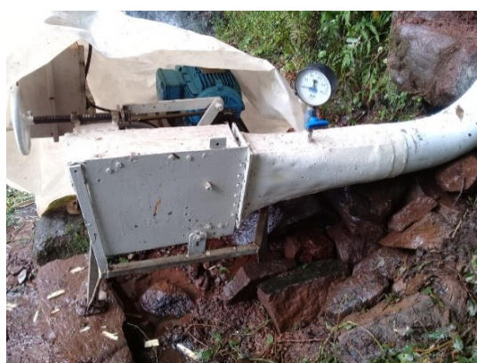
Fig. 3. Turbina, Manómetro y Generador de Prueba.
